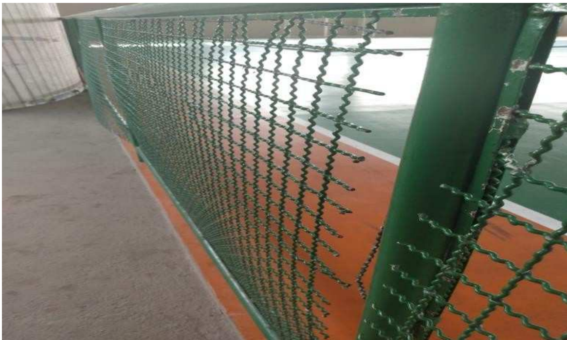
Figura 2 Grades soltas no interior da quadra esportiva
